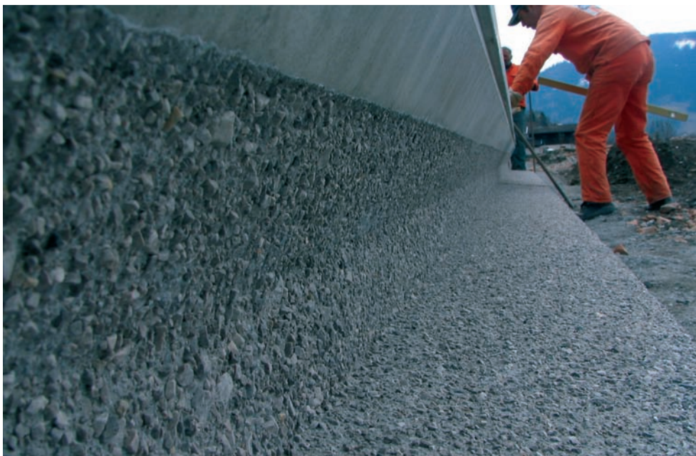
Abb. 4: Leitelement aus der "Froschperspektive" - Lauffläche und Leitwand sind aus Waschbeton, der Überhang ist mit einem zusätzlichen Überstiegsschutz versehen (FOTO: M. KYEK)
